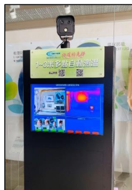
辦公大樓-紅外線影像紀錄 自動體溫量測儀
